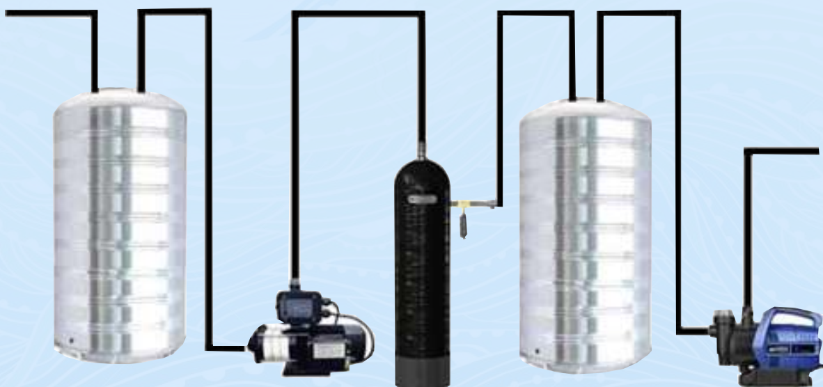
Sistem kitaran semula air wudhu yang dipasang di dalam masjid. Lokasi: Masjid Jamek Ar Rahimah, Kuala Kubu Bharu, Selangor
