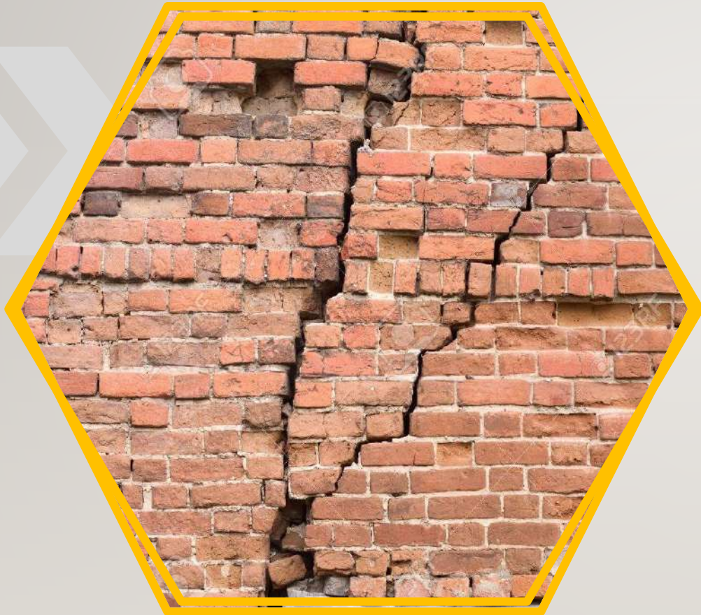
Retakan pada lantai atau bangunan berhampiran cerun
