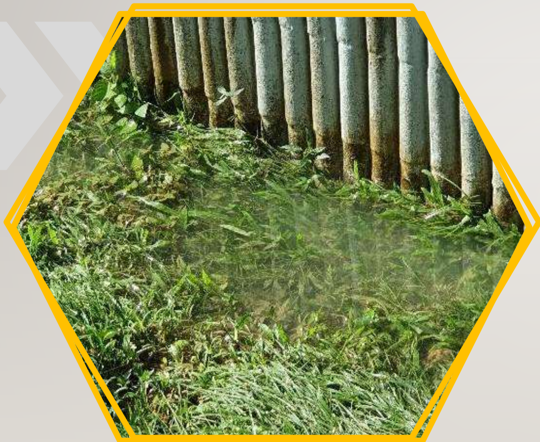
Air keluar melalui permukaan tanah di lokasi baru
